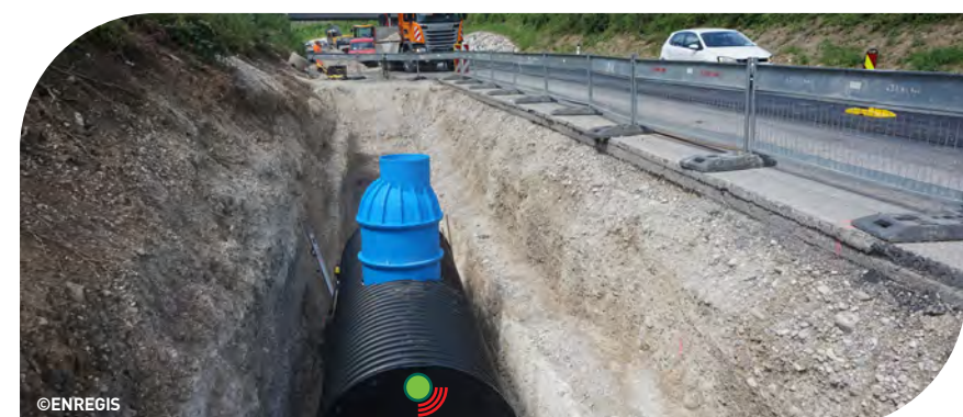
Mit ENREGIS/Vivo Biocalith® MR-F2 gefüllte Behandlungsanlage für die Regenwasserabläufe einer Bundesstraße (AT)
