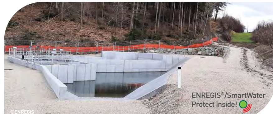
ENREGIS/Vivo Biocalith® MR-F2 in einer Behandlungsanlage für die Regenwasserabläufe eines Autobahnschnittes (AT)
